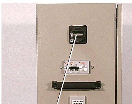
Interrupteur d'alimentation générale (Q10)
