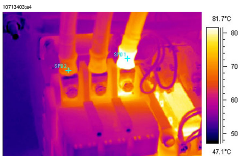
Figure 13.8 Image infrarouge d'une installation électrique extérieure (1)
