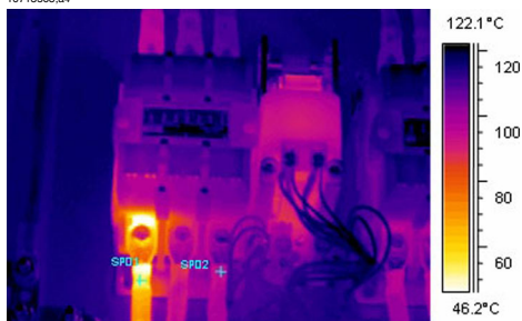
Figure 13.9 Image infrarouge d'une installation électrique intérieure (2)
