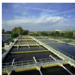
Traitement des eaux
