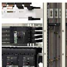
Compact NSX250 alimenté depuis le jeu de barres Linergy avec une liaison préfabriquée
