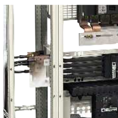
Raccordement reporté dans un compartiment à câbles
