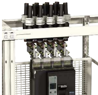
Raccordement par câbles d'un Compact NS1000 fixe prises avant
