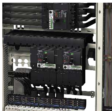
2 Compact NSX250 verticaux alimentés par un répartiteur Polypact
